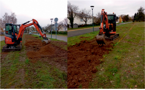
Préparation du terrain pour le chantier citoyen de plantation de haies diversifiées. Participation d'une quinzaine de collégiens du groupe environnement animé par Mme Pichon et quelques élèves de la classe ULIS viendront planter avec le service espaces verts de la commune.
